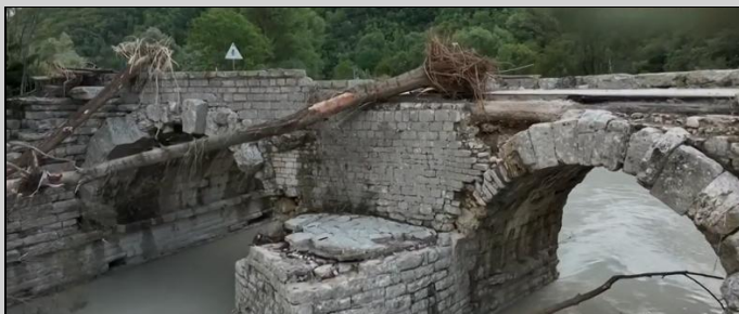
Cantiano, la Piazza e il Ponte Grosso nel giorno dell' alluvione
